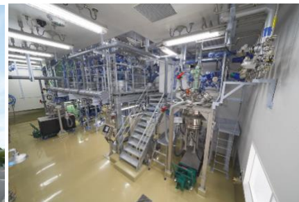
写真 3：製造棟合成室
